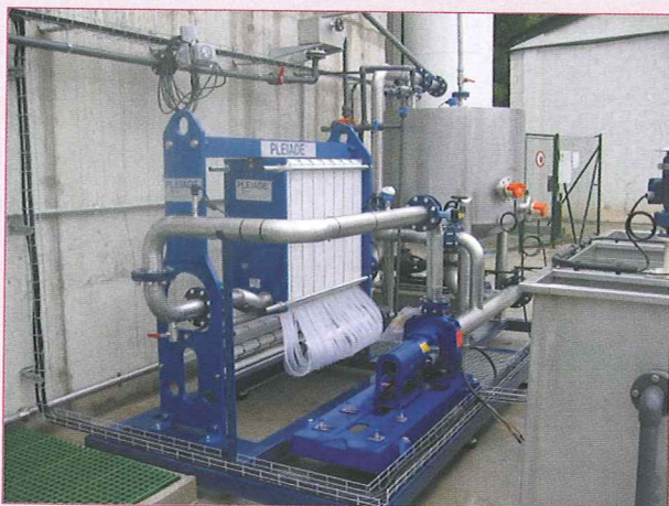
Figura 4. Módulo de ultrafiltración del sistema MBR.
