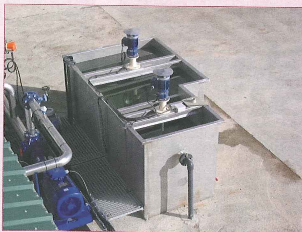
Figura 5. Tratamiento terciario: Oxidación Fenton.
