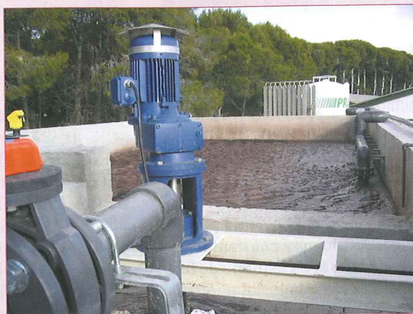
Figura 3. Reactor biológico MBR.
